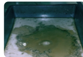
공장 내 슬러지 축적 및 부패·악취로 인해 환경 규제 기준을 초과할 위험이 있음
